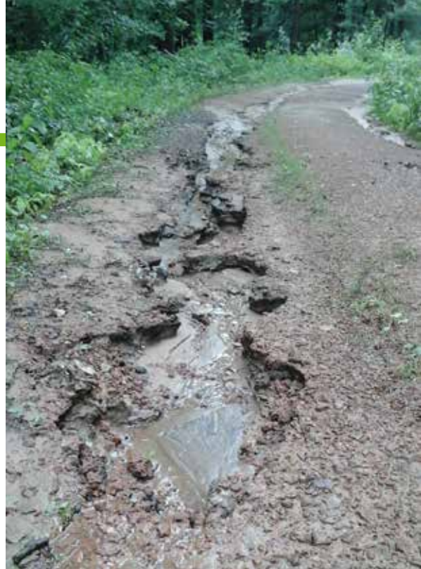
Erosionsschäden am Waldweg nach Starkregen
