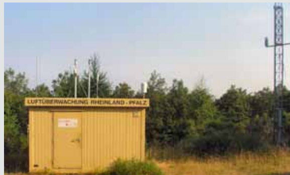
ZIMEN-Messcontainer am Hortenkopf (Umweltkontrollstation Idar-Oberstein, Hunsrück) Foto H. W. Schröck
