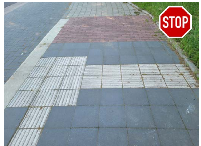
Bild 24: Einstiegsfeld und Leitstreifen korrekt, Auffindestreifen in falscher Richtung verlegt [Foto: MUKMAV]
