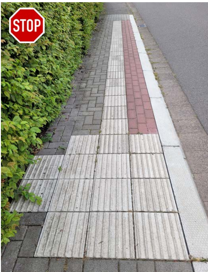
Bild 17: Zu schmale Wartefläche (ca. 120 cm breit) und zusätzliche Einengung des lichten Raumes durch Bepflanzung [Foto: MUKMAV]
