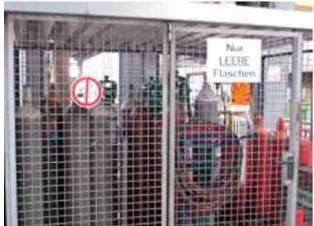
Gasflaschendepot, Rauchen verboten! Vorsicht Explosionsgefahr! Schutzeinrichtung: Metallkäfig
