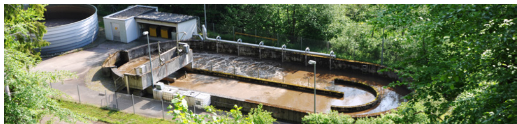
Abbildung 4: Kläranlagen Kastel (links) und Sotzweiler (rechts)
