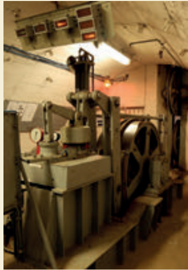
Koescheibe mit Bremsanlage und Blindschachtfördermaschine, Baujahr 1950, Foto: 2018
