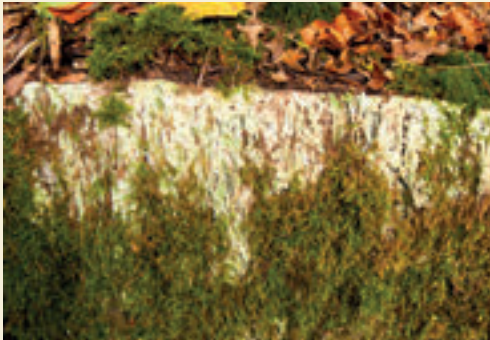
Tarnputz am Bunker WH-Nr. 67, Foto: 2018
