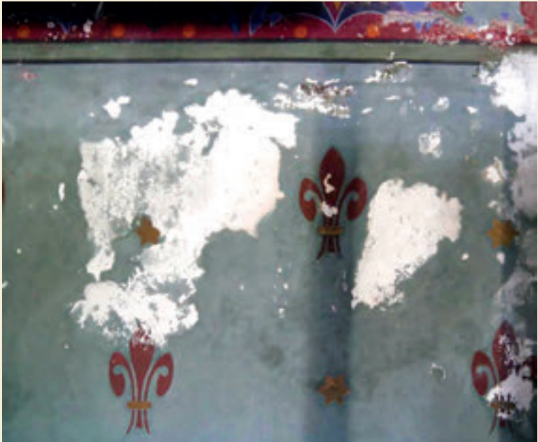
Fehlstellen in der Wandfarbfassung, Foto: 2017
