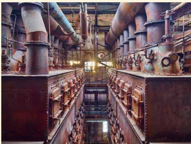
9 Leitstand TGR II nach Abschluss der Arbeiten, Foto: 2015
