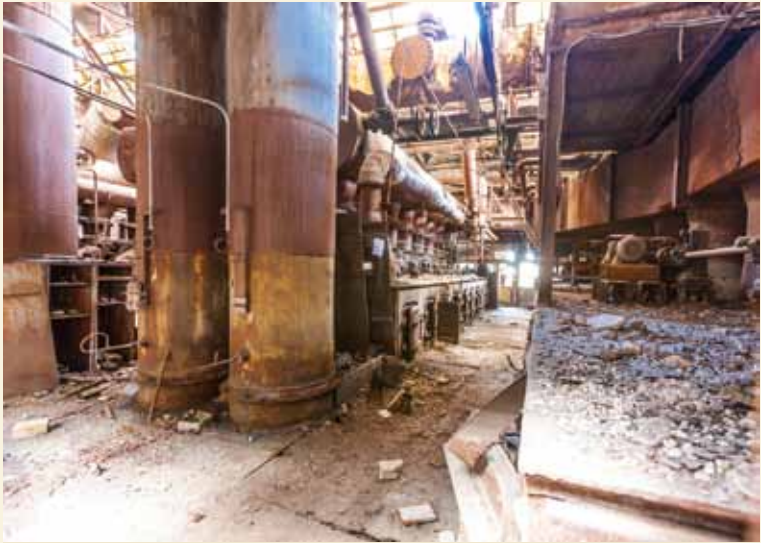
2 Zustand des Stahlbaus an der TGR I vor Sanierung, Foto: Kluge/Lobbe AG 2014
