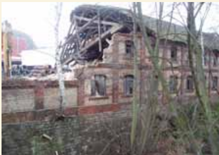
Saarpfalz-Kreis, Gemeinde St. Ingbert, Gemarkung, Gemarkung St. Ing- bert, Alleestraße 11, Koksschup- pen, 1911, später Modellager (Einzeldenkmal im Ensemble Alte Schmelz) (Löschung), Foto: 2013
