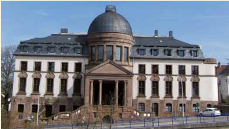
Wemmetsweiler, Rathausstraße 1, Südfassade vor Beginn der Renovierungs- und Instandsetzungsarbeiten Foto: Architekturbüro Klein, 2003
