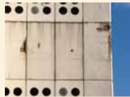
Ehemaliges Botschaftsgebäude in Saarbrücken, Schadensbild an der Westfassade, Foto 2012
