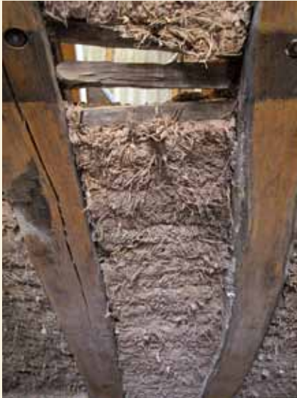
Wustweiler, Zum Stockelborn 2, marode Lehmwickeldecke, Foto: 2013
