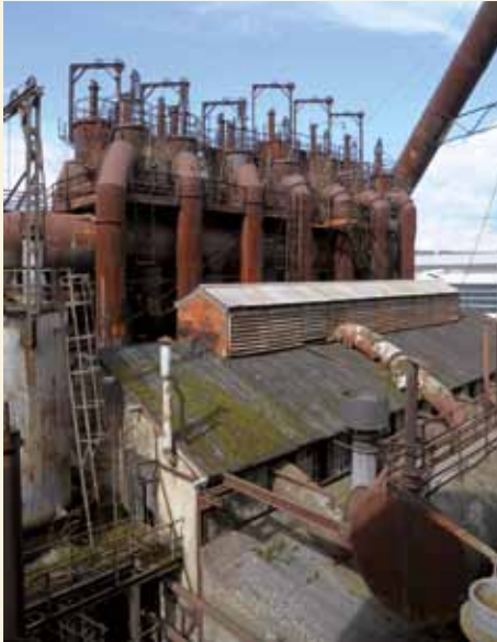
Trockengasreinigung 1, Zustand vor der geplanten Sanierung Foto: Edgar Bergstein, Minden, 2012
