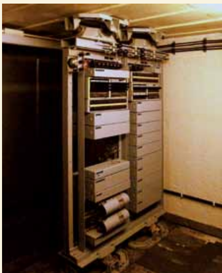
Abb. 2 Wadern, Dagstuhl, technische Einrichtung im Fernmeldebunker "SANI II", Foto: 2011
