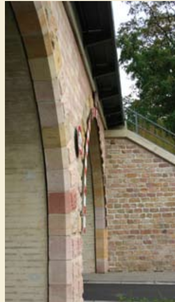
St. Ingbert: Detailansicht historische Sandsteinquader, Foto: Glöckner 2009
