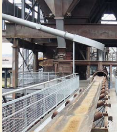
Völklingen: Bandanlage zwischen Sinterkühler und Enstaubung, Foto: Claudia Reck
