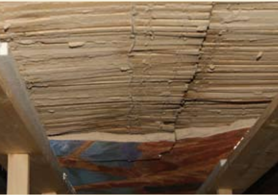
Blieskastel: Schlosskirche, großes Deckengemälde, vorläufig gesicherter Schadensbereich 2005, Foto: Hans Michael Hangleiter GmbH, Otzberg
