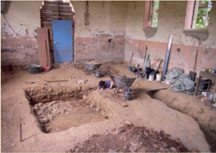
Ausgrabungen in der Wellingener Kapelle (Mitte). Rechts Kanalgraben für die neue Toilettenanlage. Foto: 2006
