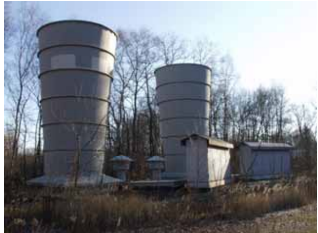
Diffusoren der Lüfteranlage
