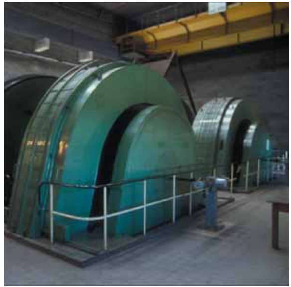
Fördermaschine im Fördererturm
