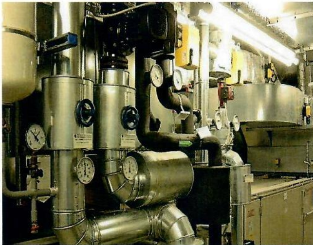
Abbildung: Teilaufnahme der raumluftechnischen Anlage mit Wärmetauscher (Quelle: LAV)
