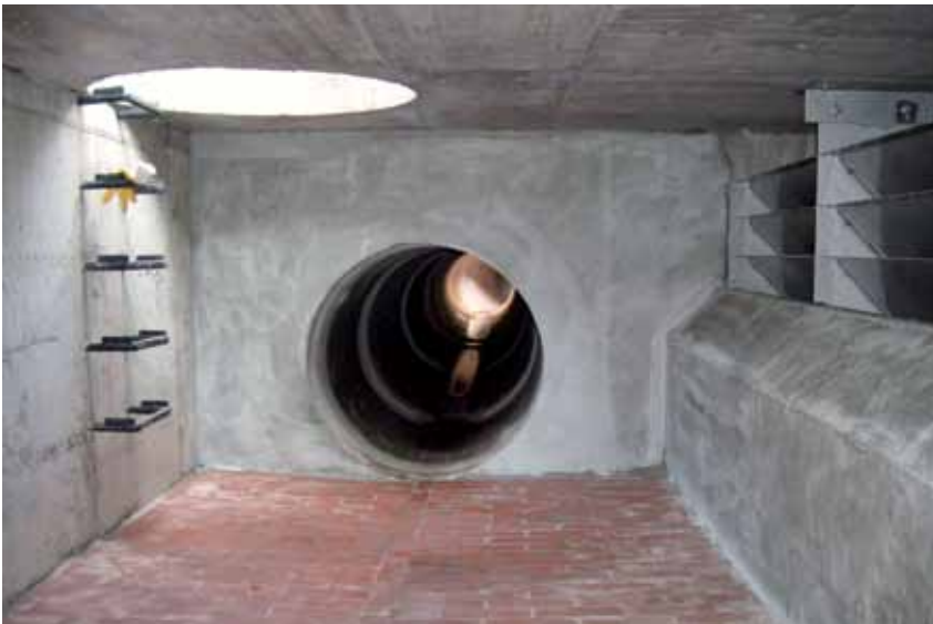
Abbildung 2: Regenüberlaufbecken in der Abwasseranlage 121
