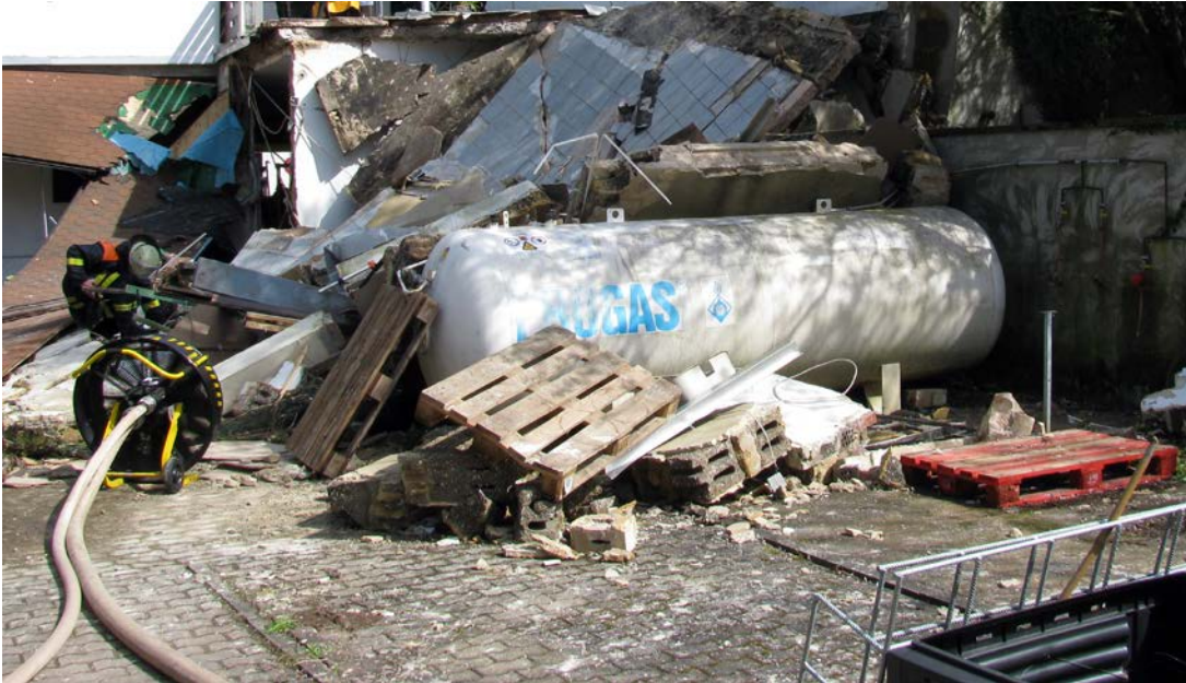
Bild 2 Durch die Wucht der Gasexplosion zerstörter Gebäudeteil
