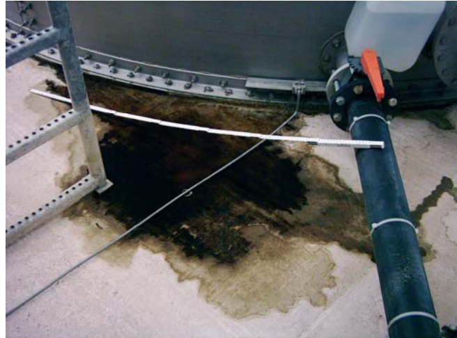
Abbildung 15 undichter Behälter (ungeeignetes Behältermaterial)
