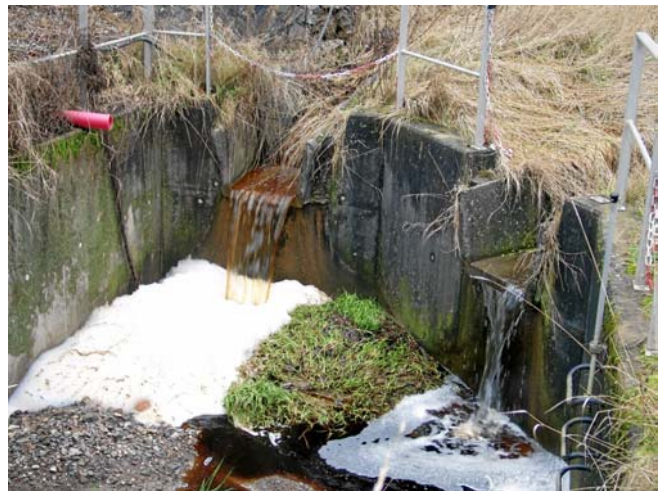
Abbildung 14 Einleitung von Jauche in ein Gewässer
